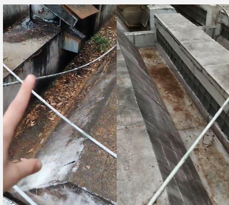
Dia de arrumação do telhado do prédio. A esquerda o antes e a direita o depois.
