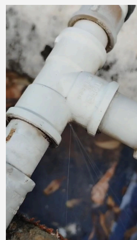
Um exemplo dos diversos vazamentos que foram constatados e arrumados.
